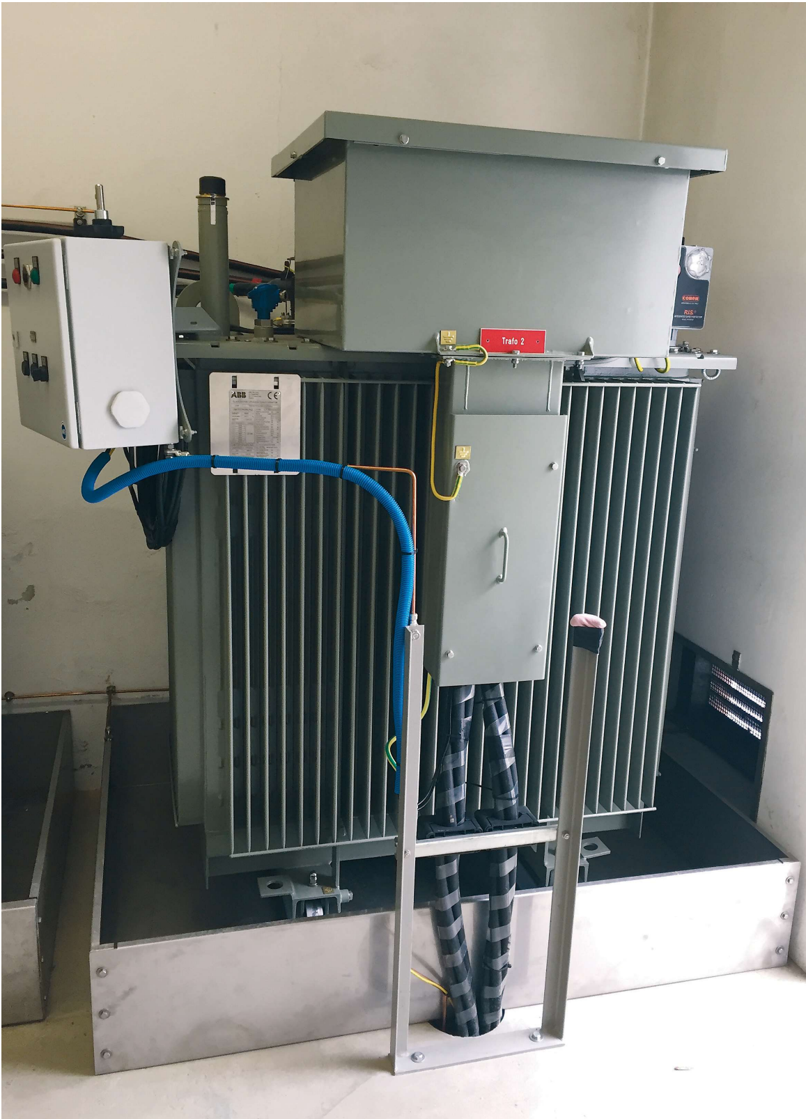
Regulierender Trafo in der TS Kreuzmatt (links: beiger Steuerkasten für die Regulierung, das Zusatzgerät für die Regulierung ist im Trafo integriert; oben: graue Abdeckung zur Reduktion der elektromagnetischen Felder)
