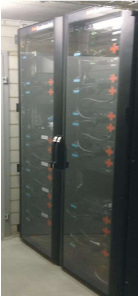
Batterieschränke des elektrischen Speichers im MFH WBGZ
